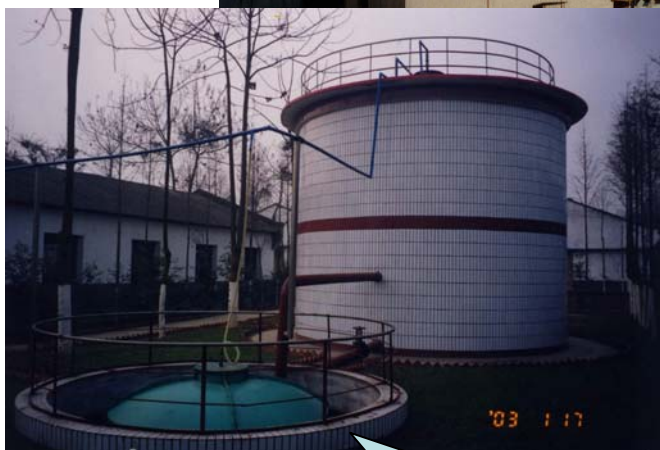
四川彭州沼气工程
