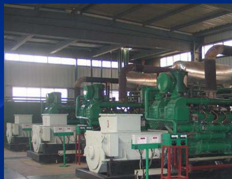
机组运行工况监测 及自动化控制
